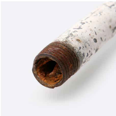
Die Korrosion in Ihrer Trinkwasserinstallation kann viele Ursachen haben
